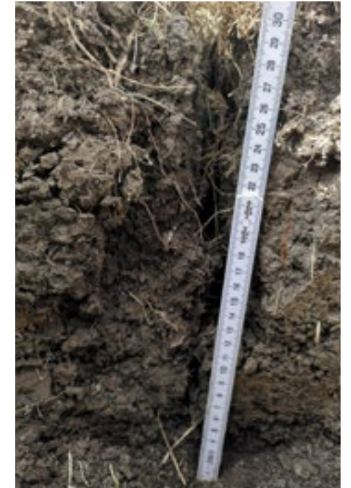
Scheur tot schalterveen Scheuren lopen door tot in het schalterveen (KV, 6 september 2022). Foto: Louis Bolk Instituut
